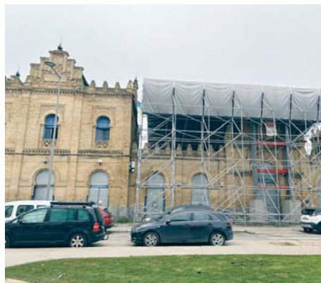
Estado actual del edificio de la vieja estación de tren. VGPALACIOS
