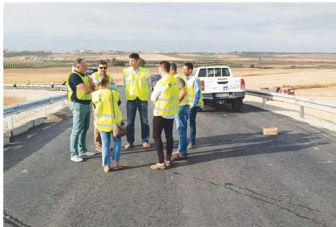
Visita a las obras en la carretera que une Paterna con Manzanilla. VH
